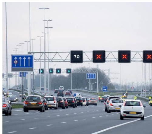
Geleiden en sturen: wegsignalering
